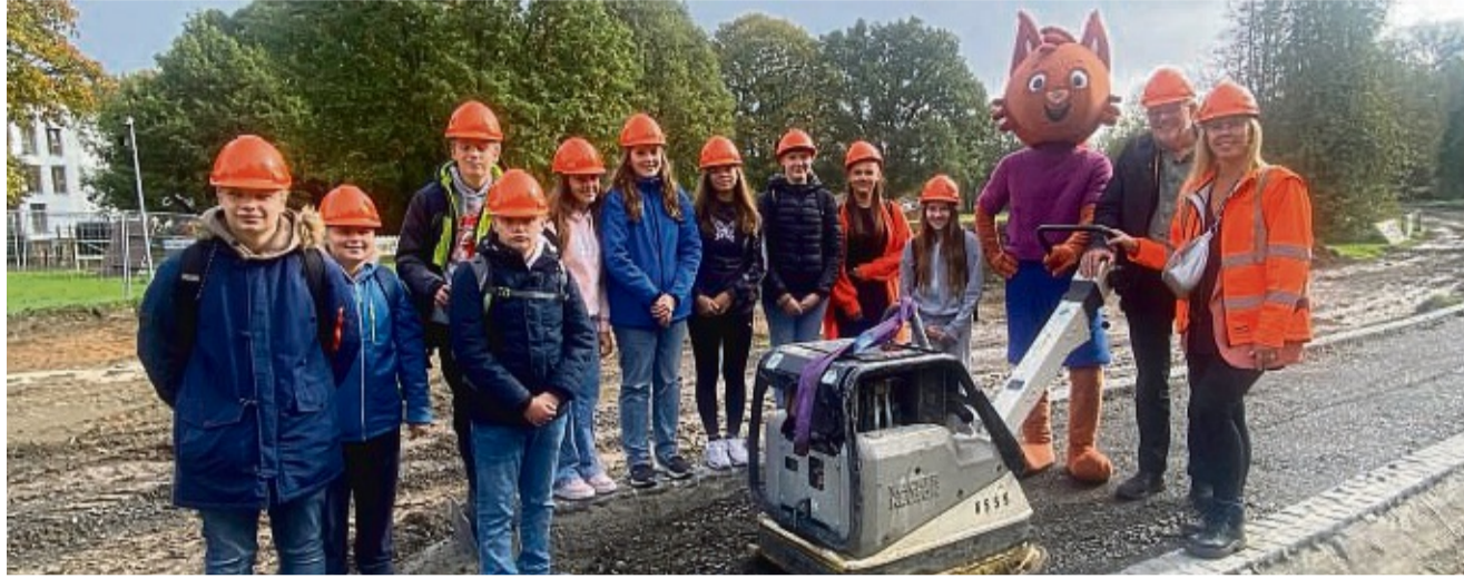
Baustellenbesuch: Schülerinnen und Schüler der 8. Klasse der Johann-Hinrich-Wichern-Realschule trafen sich im östlichen Teil des Park Schönfelds mit Maskottchen Fips sowie Stadtbaurat Christof Nolda und Projektleiterin Francisca Ditrach vom Umwelt- und Gartenamt.
